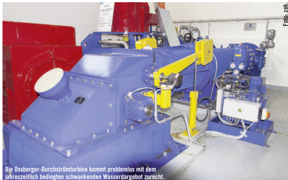
Roland Baumgartner hat den Revitalisierungsprozess des KW Gsteig von Anfang an begleitet. Mit der neuen Maschinenkombination wurde die jährliche Energieproduktion um 40 % gesteigert.
